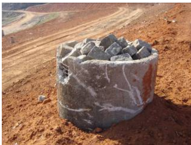
Figura 14 – Dreno vertical e ponto para dispersão dos gases
