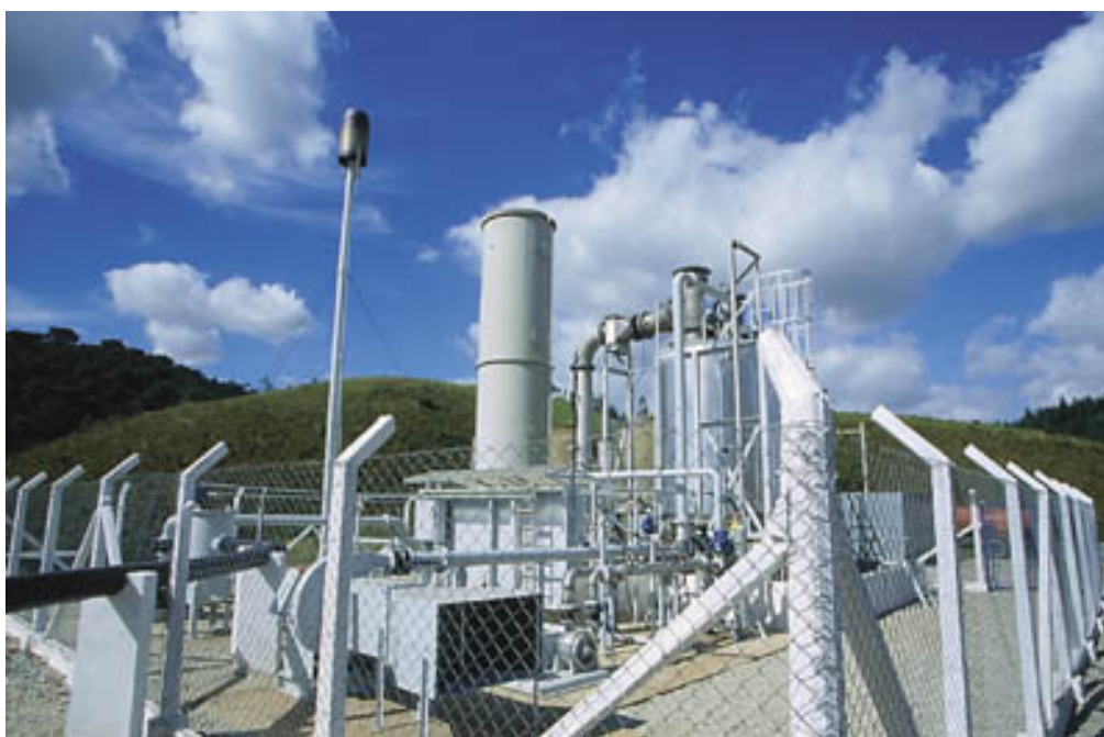
Figura 19 – Central de monitoramento e queima dos gases
